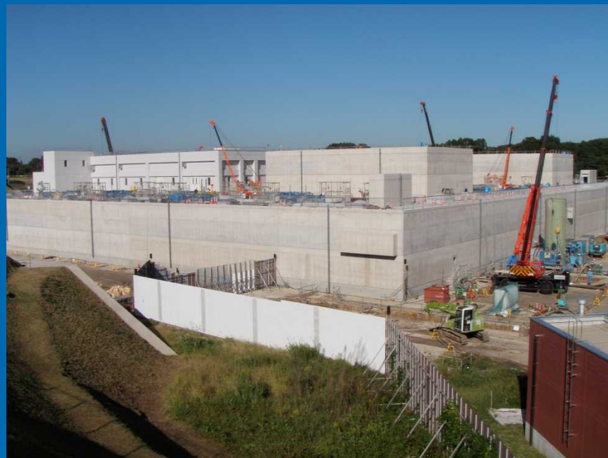
生物活性炭処理施設
