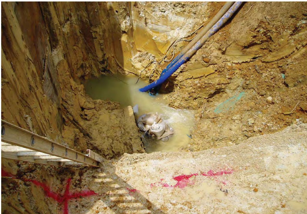
漏水箇所特定(6月13日10時 掘削深 約6m)
