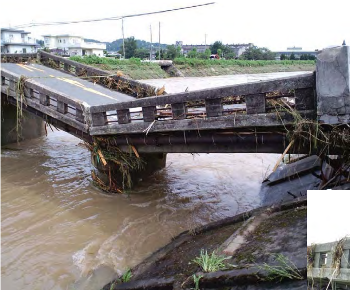
厚狭川横断主要送配水管断裂
