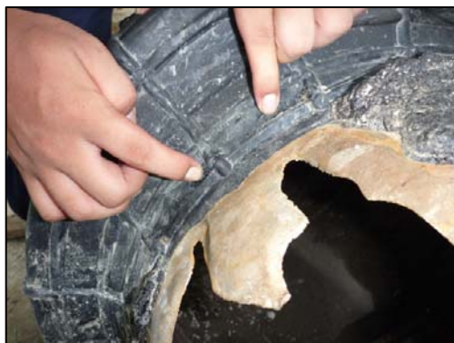
可とう管漏水部と鋼管浸食状況
