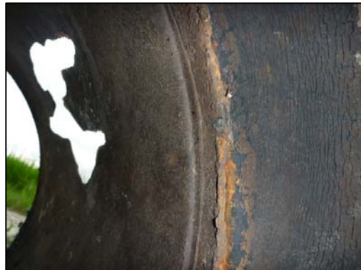
ゴム等の劣化状況
