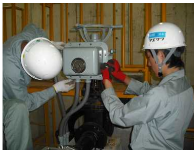
バルブの点検調査
