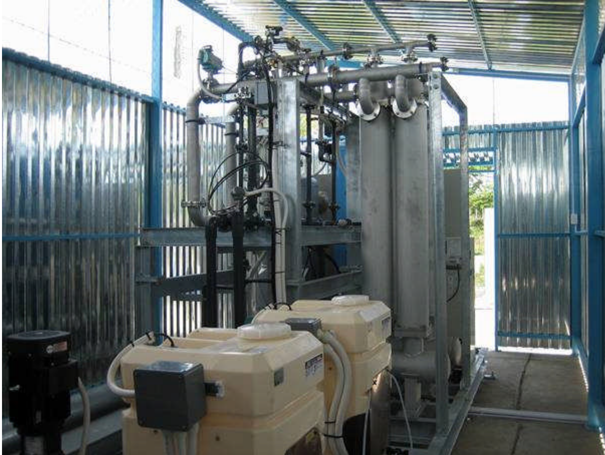
パイロットプラント
