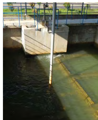
写真 1 2 ダナン市 Cau Do 浄水場ろ過池
