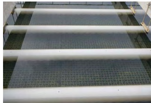
写真 2 2 フエ省 Quang Te 浄水場沈澱池
