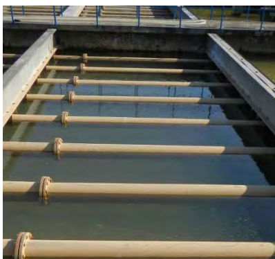
写真 1 1 ダナン市 Cau Do 浄水場 沈澱池
