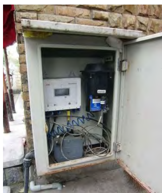
写真 1 7 ダナン市内に設置された流量計
