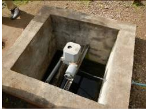
Malkapur 配水場に設置されている配水タンク水位計。むき出しの単線で信号を送っている。
