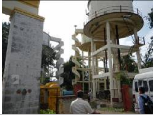
Malkapur の配水場。
