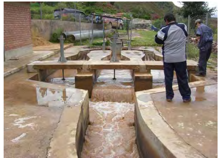
導水路中の沈砂池 導水路には、いくつかの沈砂池が設けられている。雨期は濁度が高いため、毎日の維持管理が求められる。しかし十分に流速が落とせず、濁度もあまり落ちていない。
