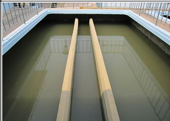
首都ビエンチャン水道局 カオリオ浄水場（水源はメコン河表流水、ろ過地への流入水の濁度が高い）
