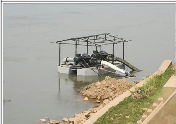
首都ビエンチャン水道局 カオリオ浄水場臨時取水ポンプ（乾季のためメコン河水位低下対策フローティングポンプでの取水）
