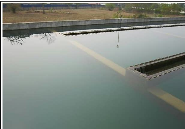
首都ビエンチャン水道局 ドンマカイ浄水場（凝集沈殿状態良好）
