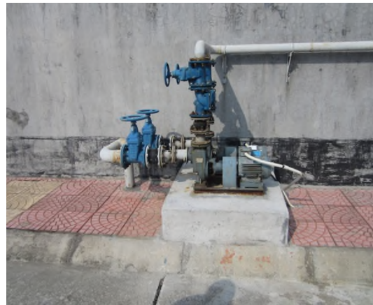
図 4-15 水道施設 (給水ポンプ)
