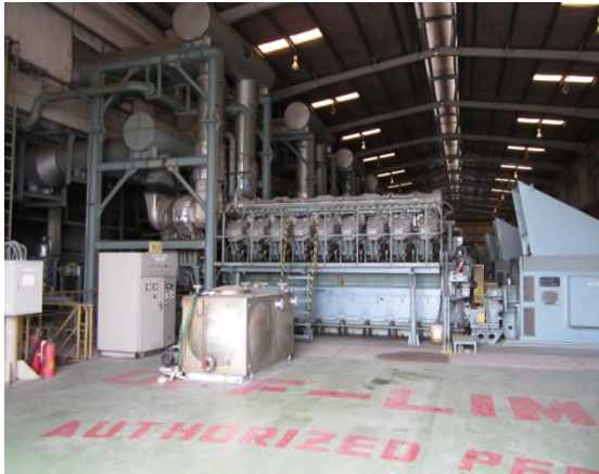
図 4-6 水道施設の概況（自家発電）
