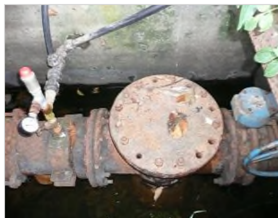
図 4-17 水道施設 (ストレーナー)
