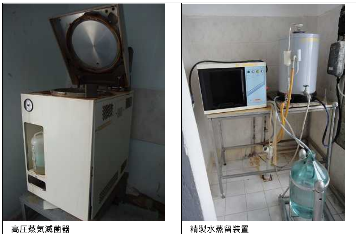
写真 - 5 ジェイランバタン浄水場内の水質試験室の分析機器など
