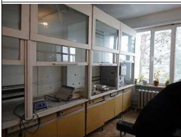
化学試験室内のドラフト
