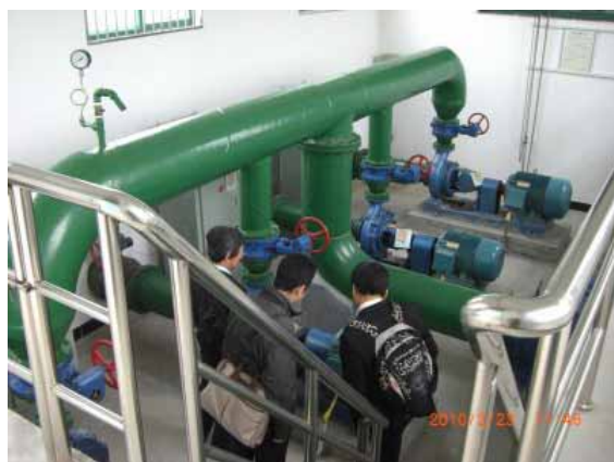
バックアップ用の増圧ポンプ
