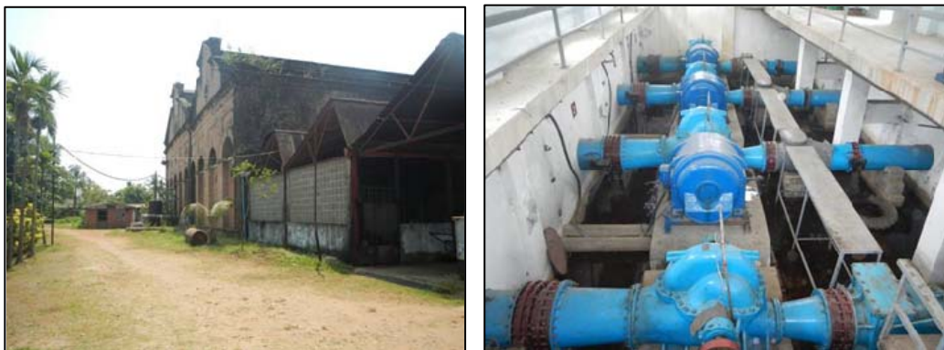
図 5-6 (左)次亜塩生成設備格納棟全景、(右)ポンプ室
