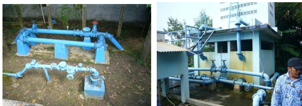
図 4-6 (左)深井戸上部、(右)浄水場上部
