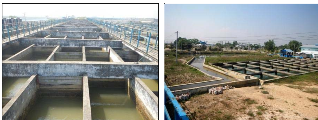
図 5-4 (左)凝集混和池、(右)浄水池全景
