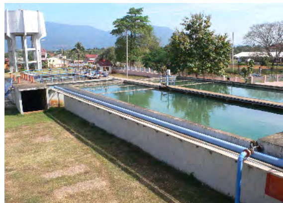
パクセ浄水場 (県水道公社が運転・維持管理を実施)
