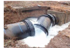
東日本大震災における継手離脱
