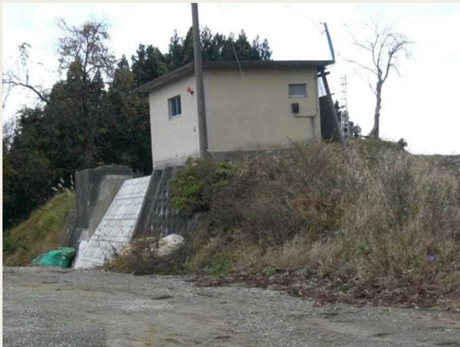
中越地震(H16. 10. 23)により、施設が傾斜
