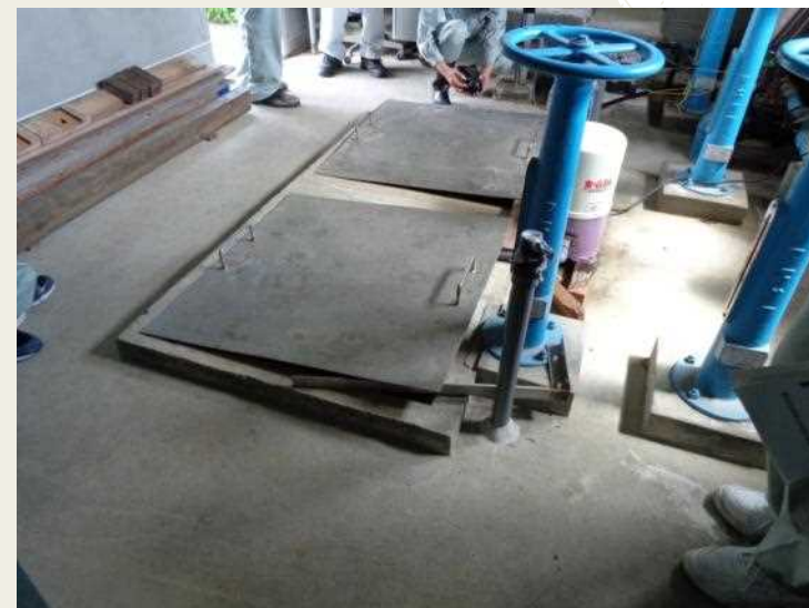
床面は約4度傾いている
