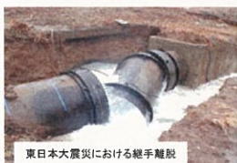
東日本大震災における継手離脱
