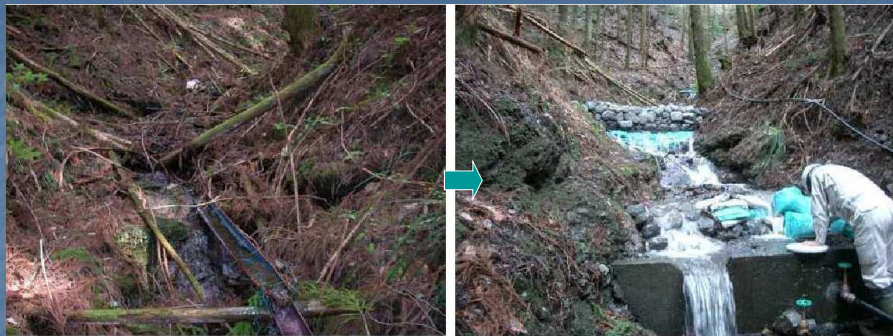
(施工前) 雨どいだけの取水施設
