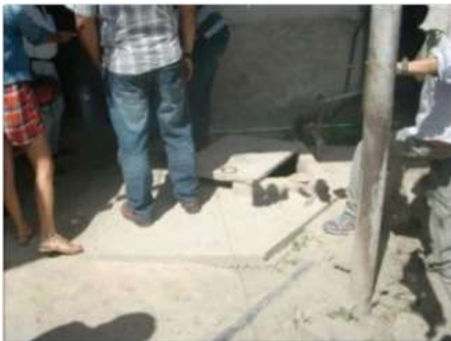
写真1 家庭の地下配水タンク
