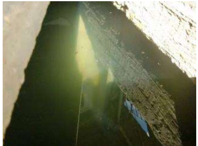
写真2 配水タンクの中の水
