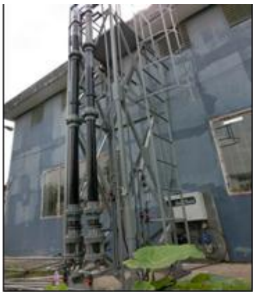
パイロットプラント全景
