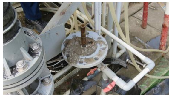
配水部にも多量の泥の付着が認められる
