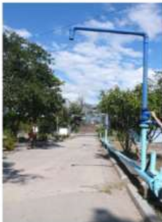
No.15 井戸水の給水車用水栓 給水車に水を入れるための施設。
