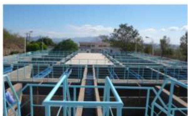
No.12 Parada浄水場 1987年に建設された、キューバ式の浄水場。処理能力は、300L/s。将来450L/sまで処理できるように拡張する計画。
