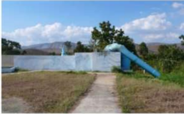
No.7 Quintero I・II 浄水場の着水井 Gilbert、Charco Mono、Gota Blanca、Chalónsダムから導水している。
