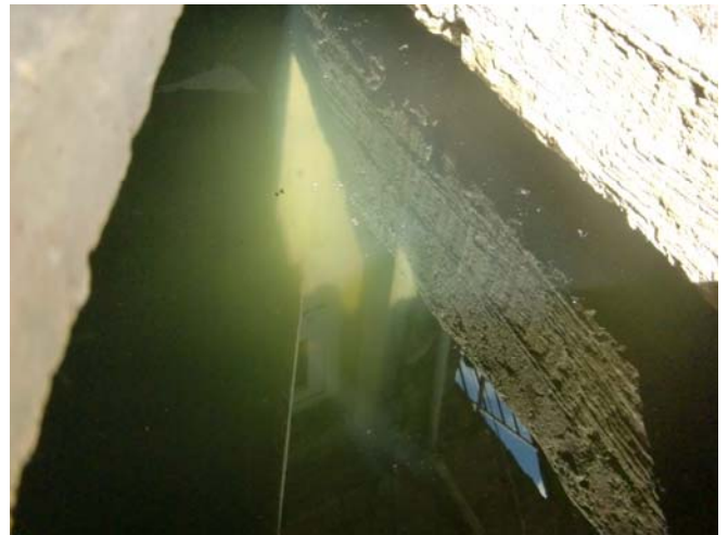
写真2 配水タンクの中の水
