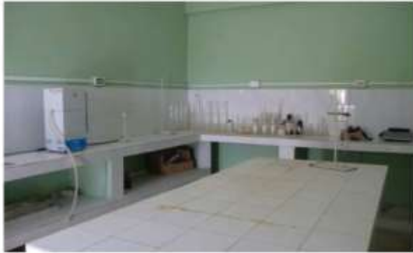
No.13 Parada浄水場の水質試験室 水質試験室は、きれいに整理されているが、一部の機器が故障している。
