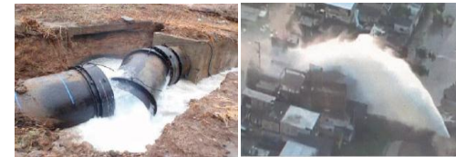
東日本大震災における継手離脱
