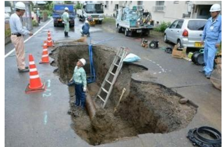
漏水による陥没事故（大分市）
