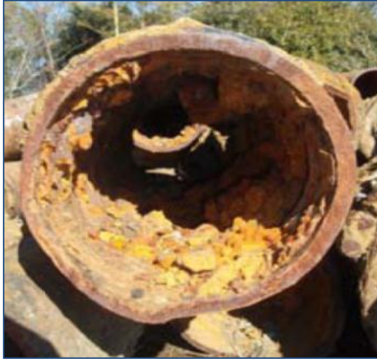
経年化による内面腐食
