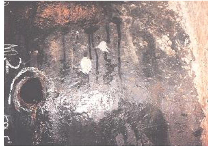
鋼管の局部腐食
