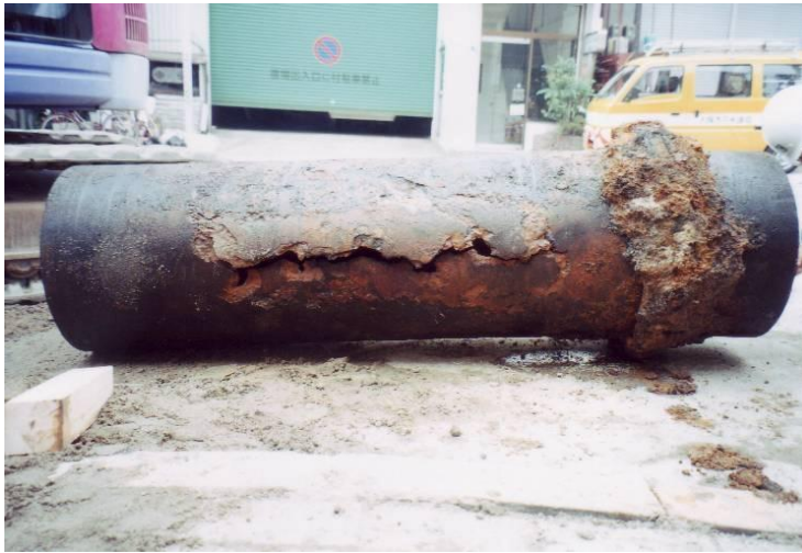
腐食性土壌による管体腐食
