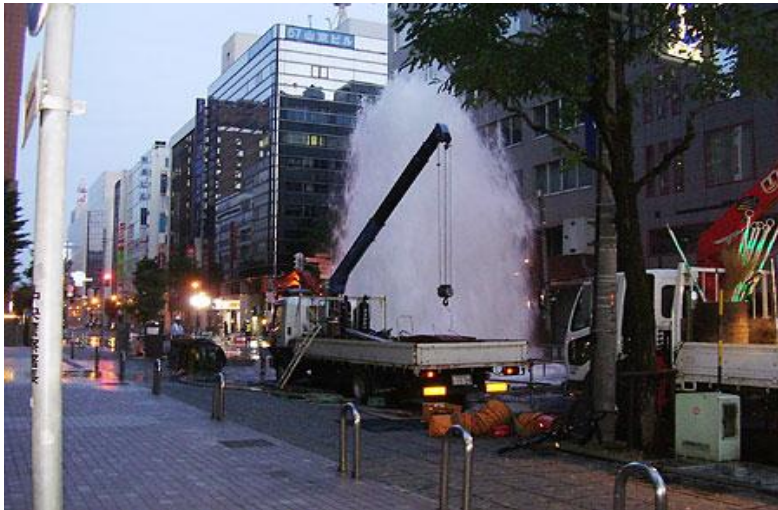
街中での漏水事故（札幌市）
