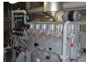
自家発電装置
