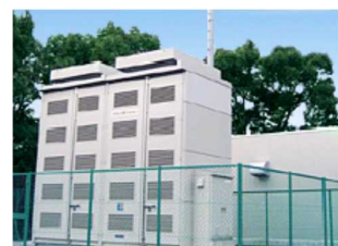
蓄電池 (NAS電池)
