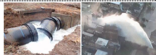
東日本大震災における継手離脱
