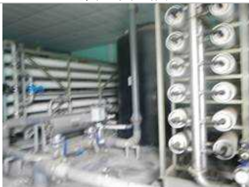
海水淡水化施設
