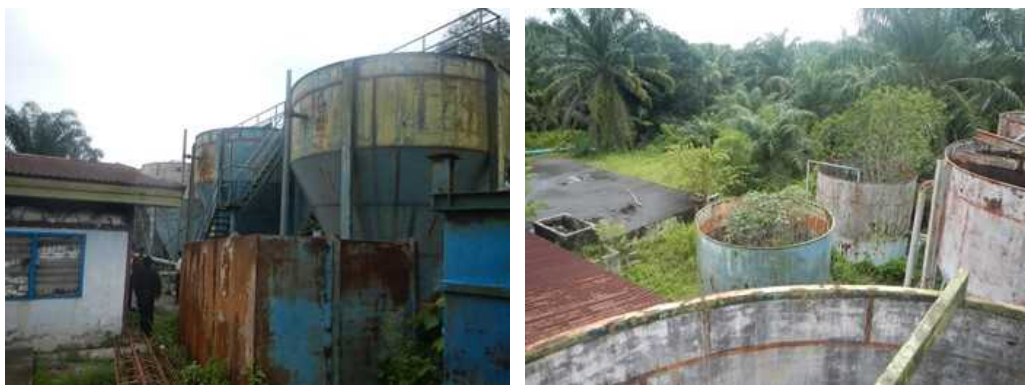
図 11 遺棄された Masjid 浄水場敷地内の浄水設備
