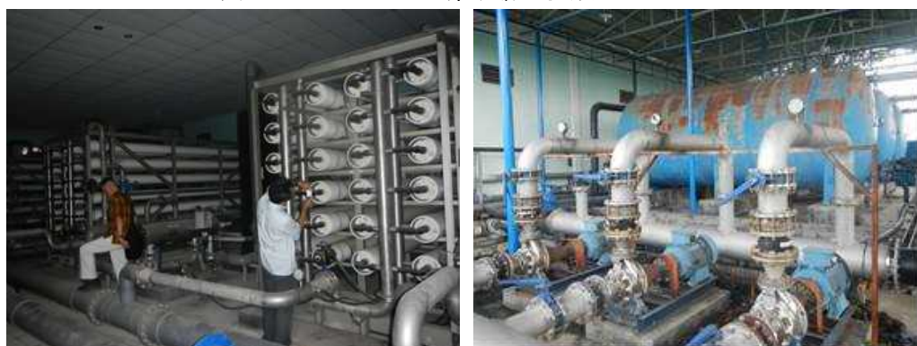
図 13 遺棄された Sudirman 浄水場内の海水淡水化施設
