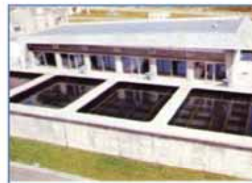
急速ろ過池（中津原浄水場）
