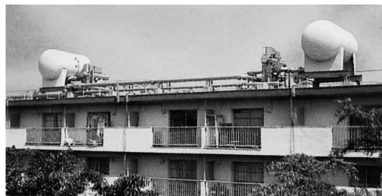
(2) 屋上に設置された蓄圧水槽
