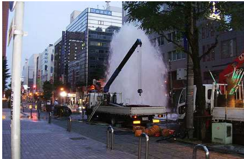
街中での漏水事故（札幌市）
