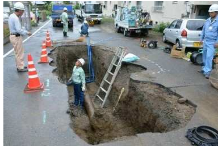
漏水による陥没事故（大分市）
