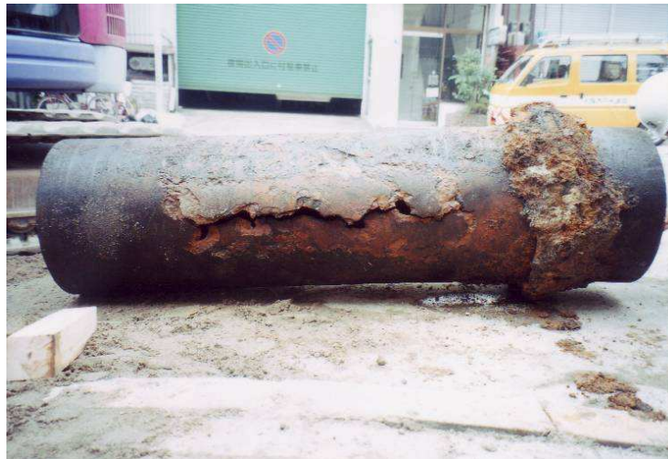
腐食性土壌による管体腐食
