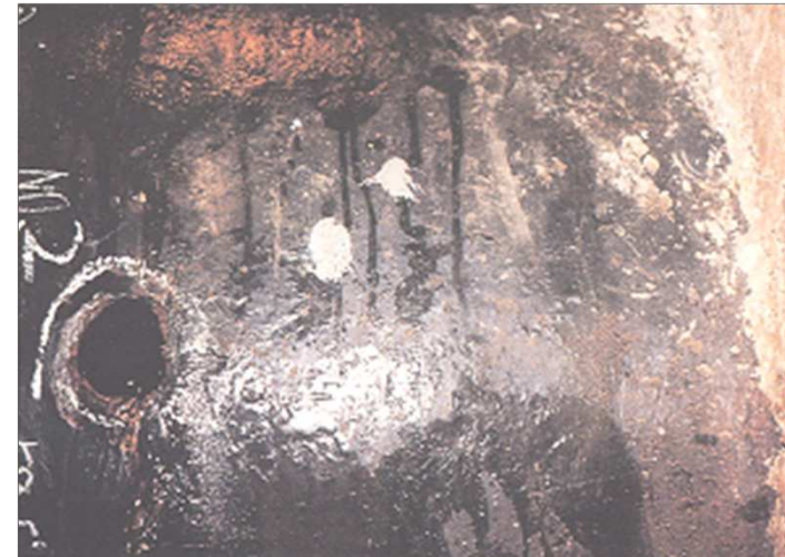
鋼管の局部腐食
