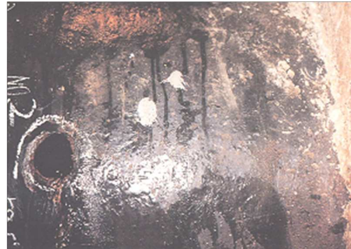
鋼管の局部腐食
