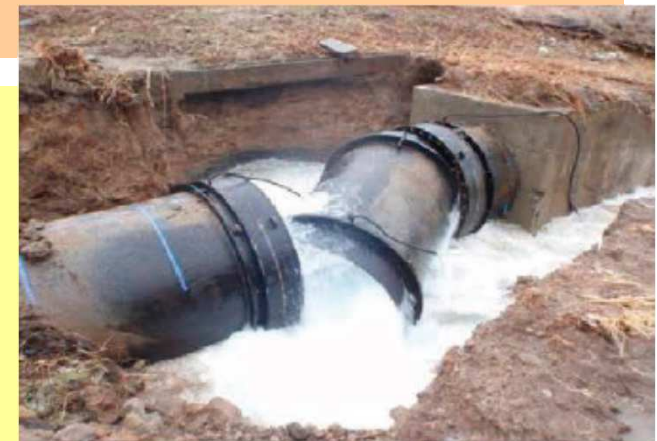
東日本大震災における継手離脱
