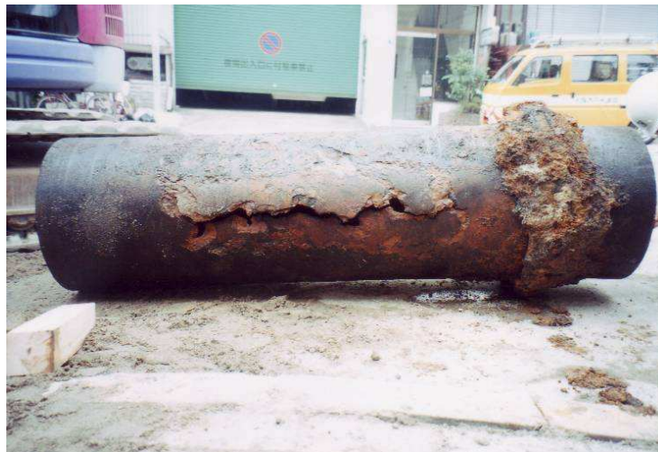
腐食性土壌による管体腐食
