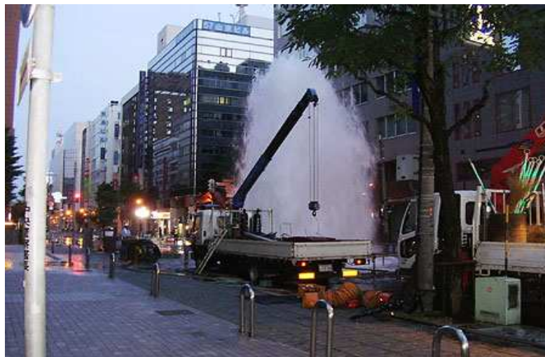
街中での漏水事故（札幌市）
