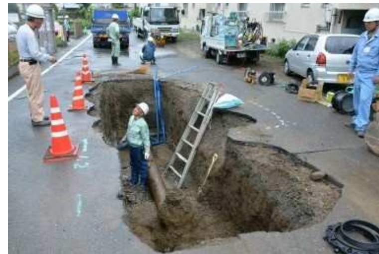
漏水による陥没事故（大分市）
