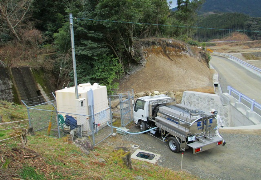
持田地区配水タンクへの注水状況
