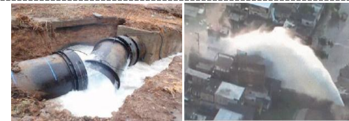
東日本大震災における継手離脱
