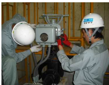
バルブの点検調査
