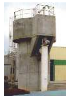
Uチューブオゾン接触装置
