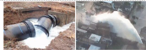
東日本大震災における継手離脱
