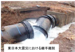
東日本大震災における継手離脱
