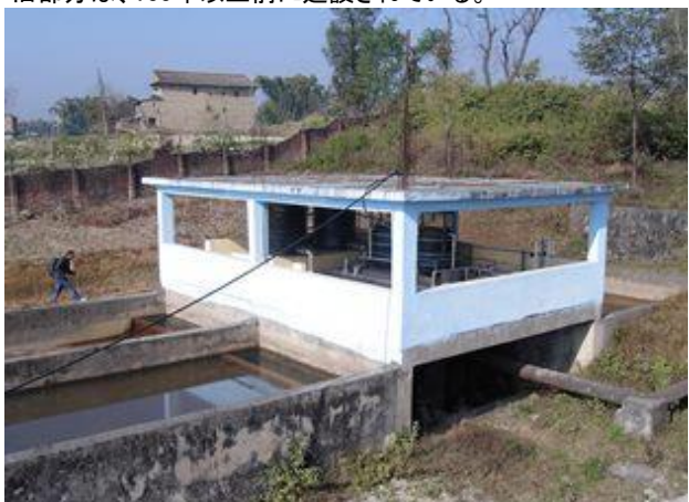
バンスバリ浄水場 ろ過池
