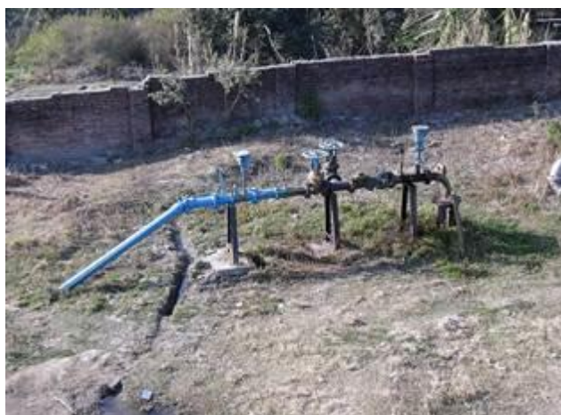
ポデの井戸群のひとつ ポデ配水池敷地内にある井戸ポンプ
