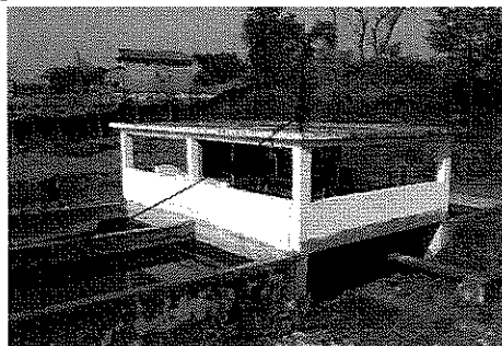
バンスバリ浄水場 ろ過池
