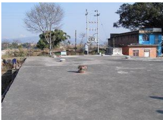
ボーデの配水池 配水池容量は1,000m 3 ある。マノハラ浄水場から送水され、マディアプールとバクタプールへ配水している。
