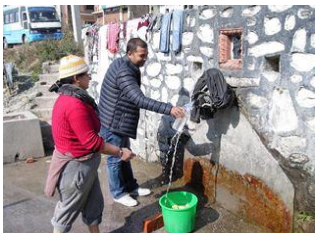
バンスバリ浄水場直近の公共水栓
