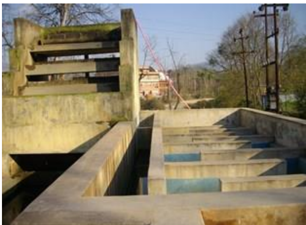
市内の小規模浄水場(ジャガティ浄水場) 配水容量100m 3 の配水池である。
