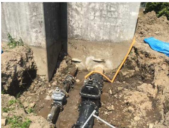
水源着水井管路接続部損傷
