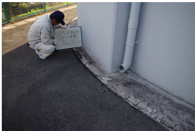
写真 6.7.2 日吉ヶ丘配水池の PC タンク基礎のクラック（モルタル部） （大津菊陽水道企業団）
