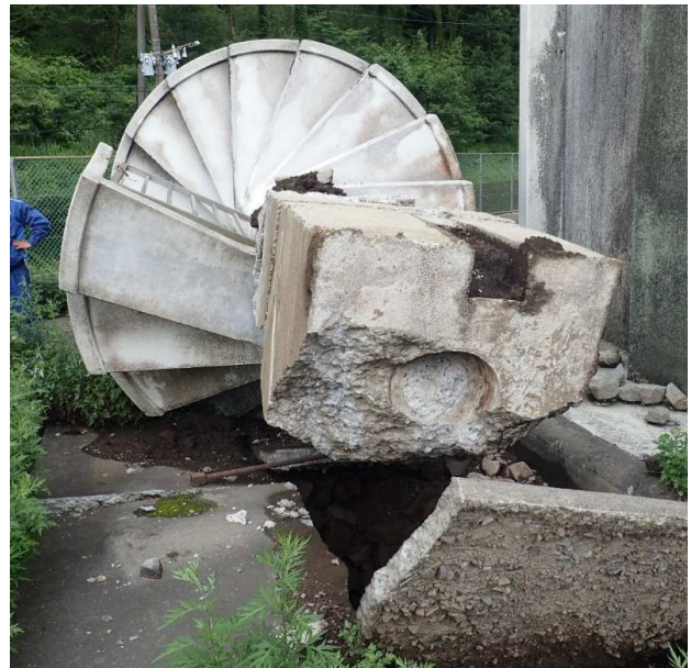
写真 6.4.1 阿蘇市の被災状況
