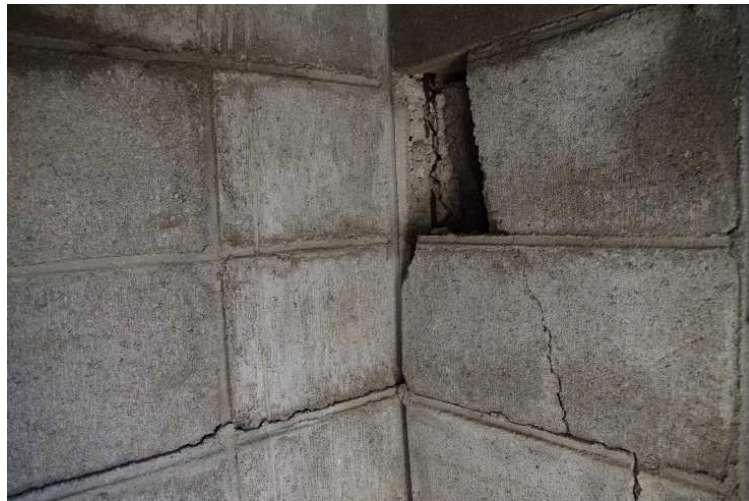
写真 6.7.4 平川第1水源建屋 コンクリートブロックのクラック （大津菊陽水道企業団）
