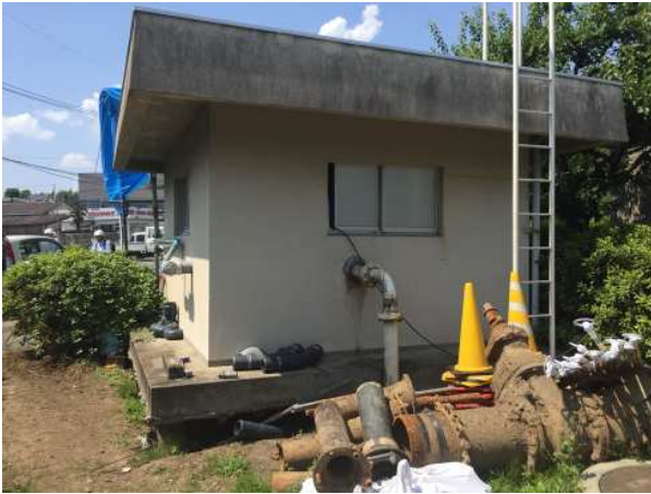
水源建屋基礎損傷
