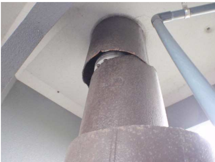
■沼山津9井のケーシングの損傷
