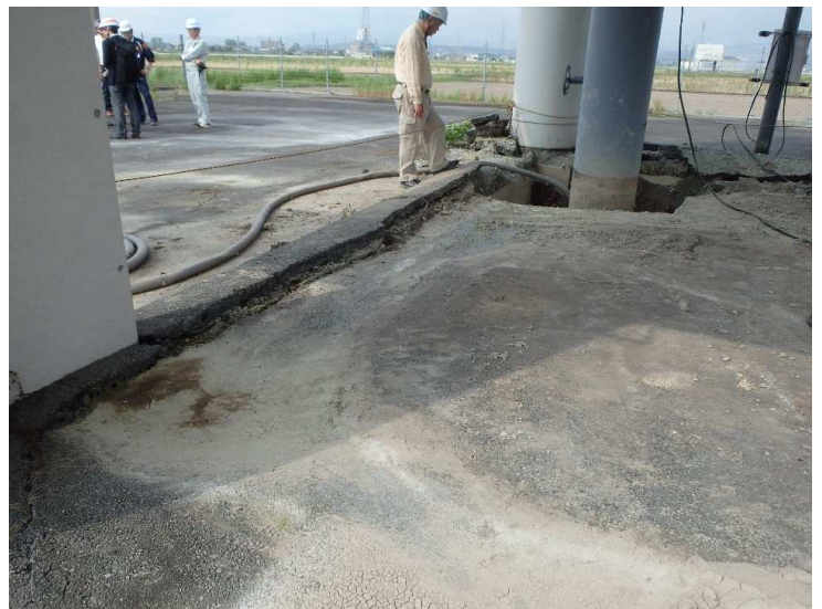
■秋田第2水源池 地盤沈下状況
