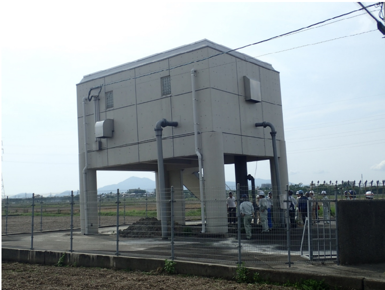
■秋田第2水源池 建屋傾斜
