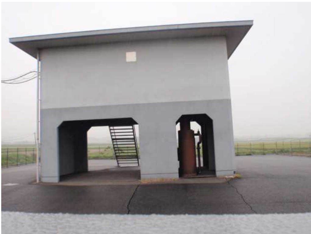
取水施設 沼山津8井 建物傾斜・構内沈下
