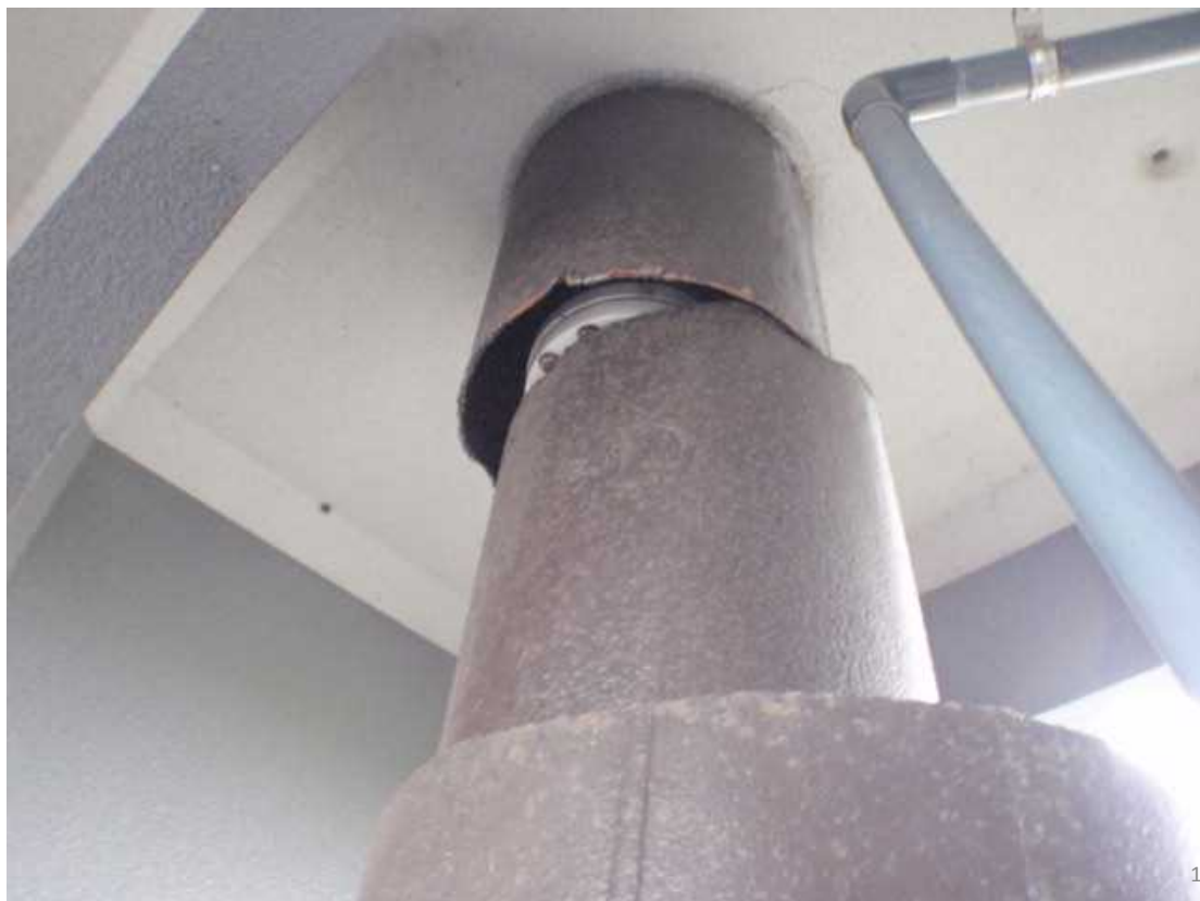
取水施設 沼山津9井 取水ケーシング損傷
