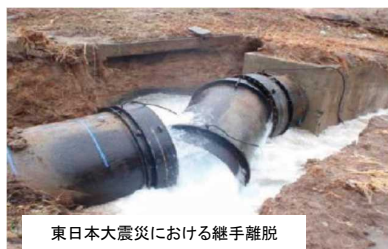
東日本大震災における継手離脱
