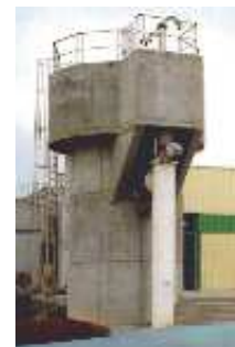
Uチューブオゾン接触装置
