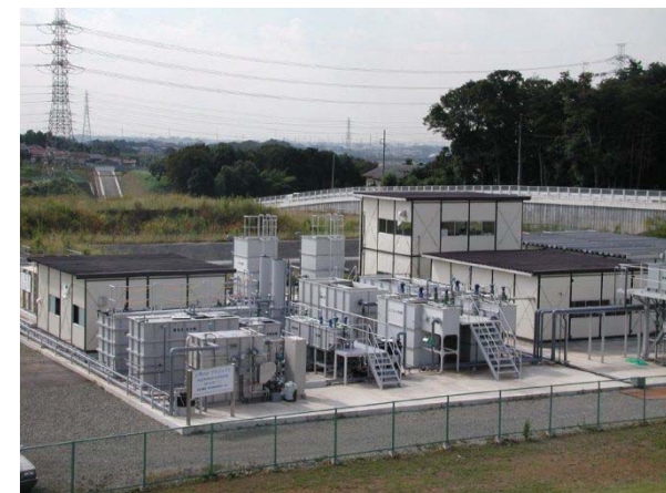
合同実験プラント (神奈川県内広域水道企業団綾瀬浄水場内)
