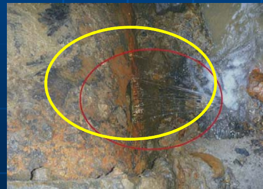
老朽管の被害
