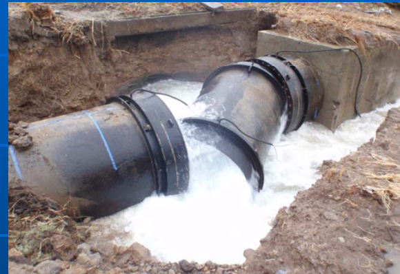
基幹管路の断水
