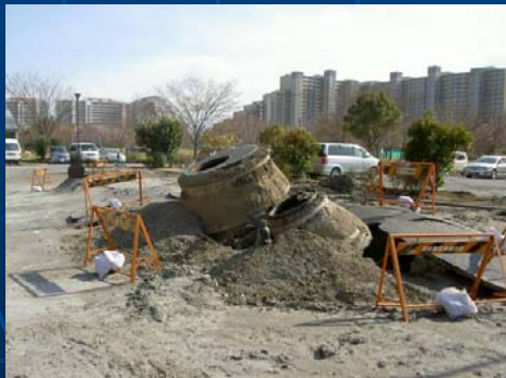
液状化による被害
