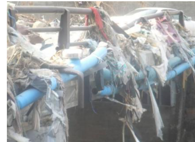
南三陸歌津駅付近 鋼管橋梁添架 津波被害
