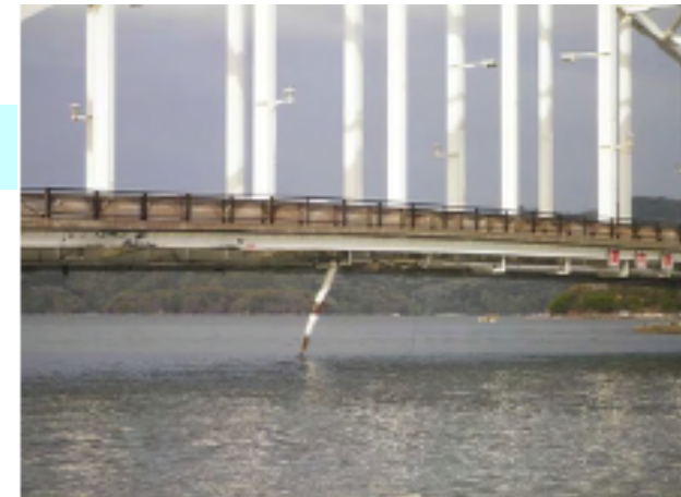
万石橋梁添架管の被災状況(石巻地方広域水道企業団)
