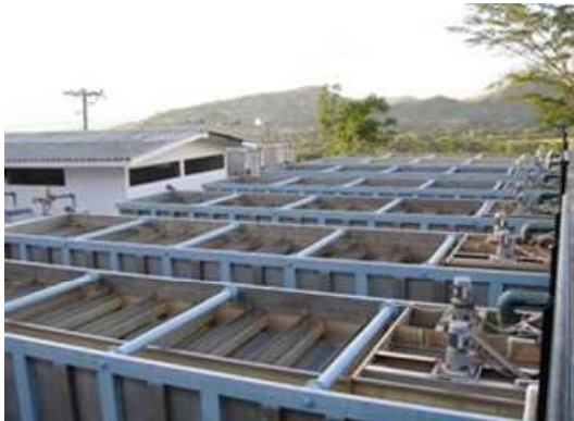
Sedimentador rápido del sistema de tratamiento de agua construido con la cooperación española
