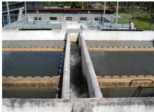
Planta de tratamiento de agua existente del sistema fluvial del río Calán
