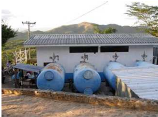
Tanques de filtro de presión del sistema de tratamiento de agua construido con la cooperación española
