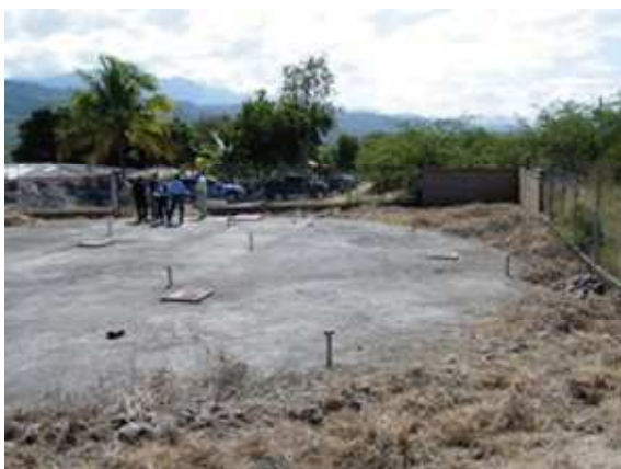
Tanque de distribución existente (redondo: capacidad: 1.000 m 3 )
