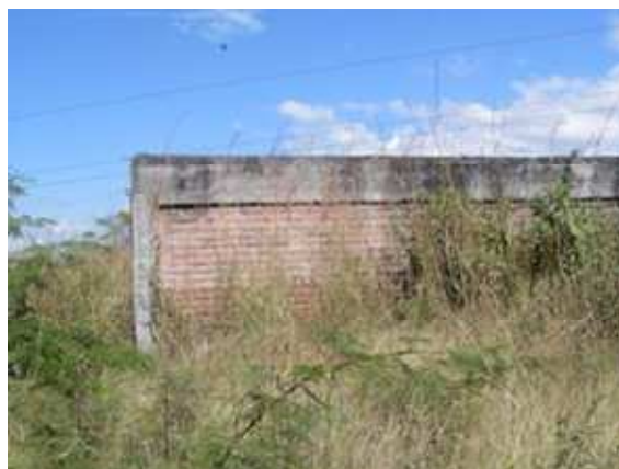
Tanque de distribución existente (cuadrado: capacidad: 380 m 3 )
