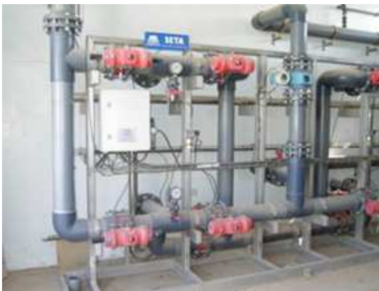
Planta de tratamiento de agua existente: Sistema de tratamiento construido con la cooperación española
