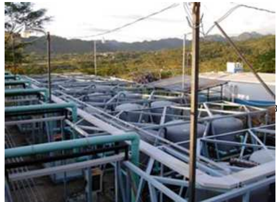
Tanque de filtro de presión del sistema de tratamiento de agua construido con la cooperación española
