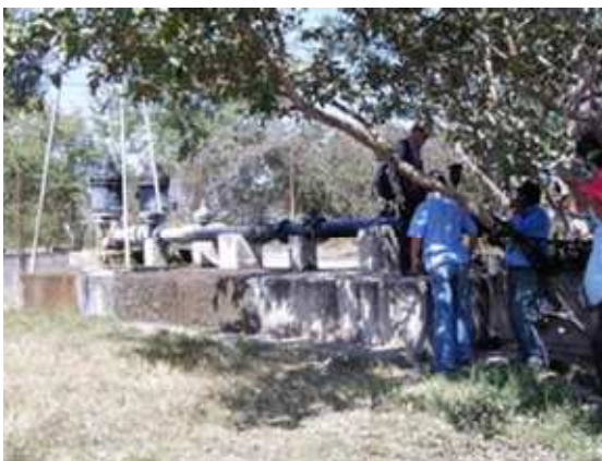
Estación de bombeo intermedia
