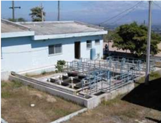
Planta de tratamiento de agua existente: Sistema de tratamiento “convencional”
