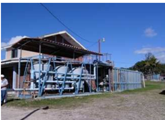
Instalaciones de tratamiento de la toma de agua del valle de Guaratoro
