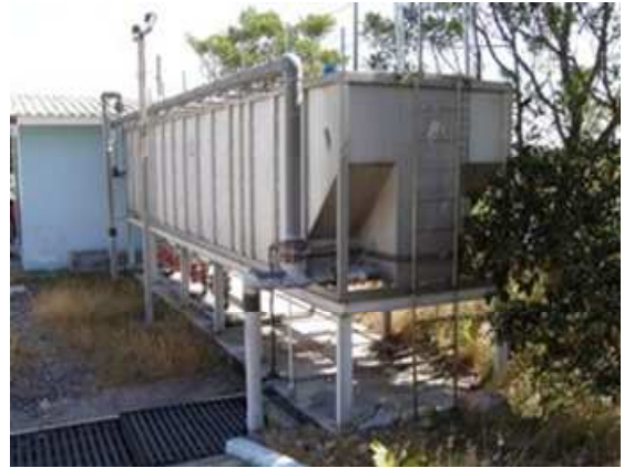
Planta de tratamiento de agua existente: Sistema de tratamiento construido con la cooperación española
