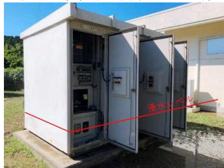
写真 3-8 ポンプ場建屋外浸水レベル（台風第19号；福島県いわき市 法田ポンプ場）
