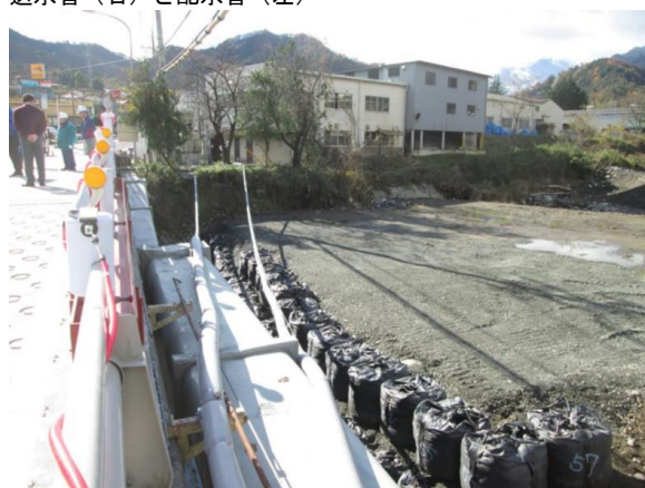
送水管（左）と配水管（右）
