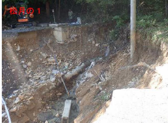
写真 3-41 道路崩落による管路の破断（台風第 19 号；岩手県宮古市）
