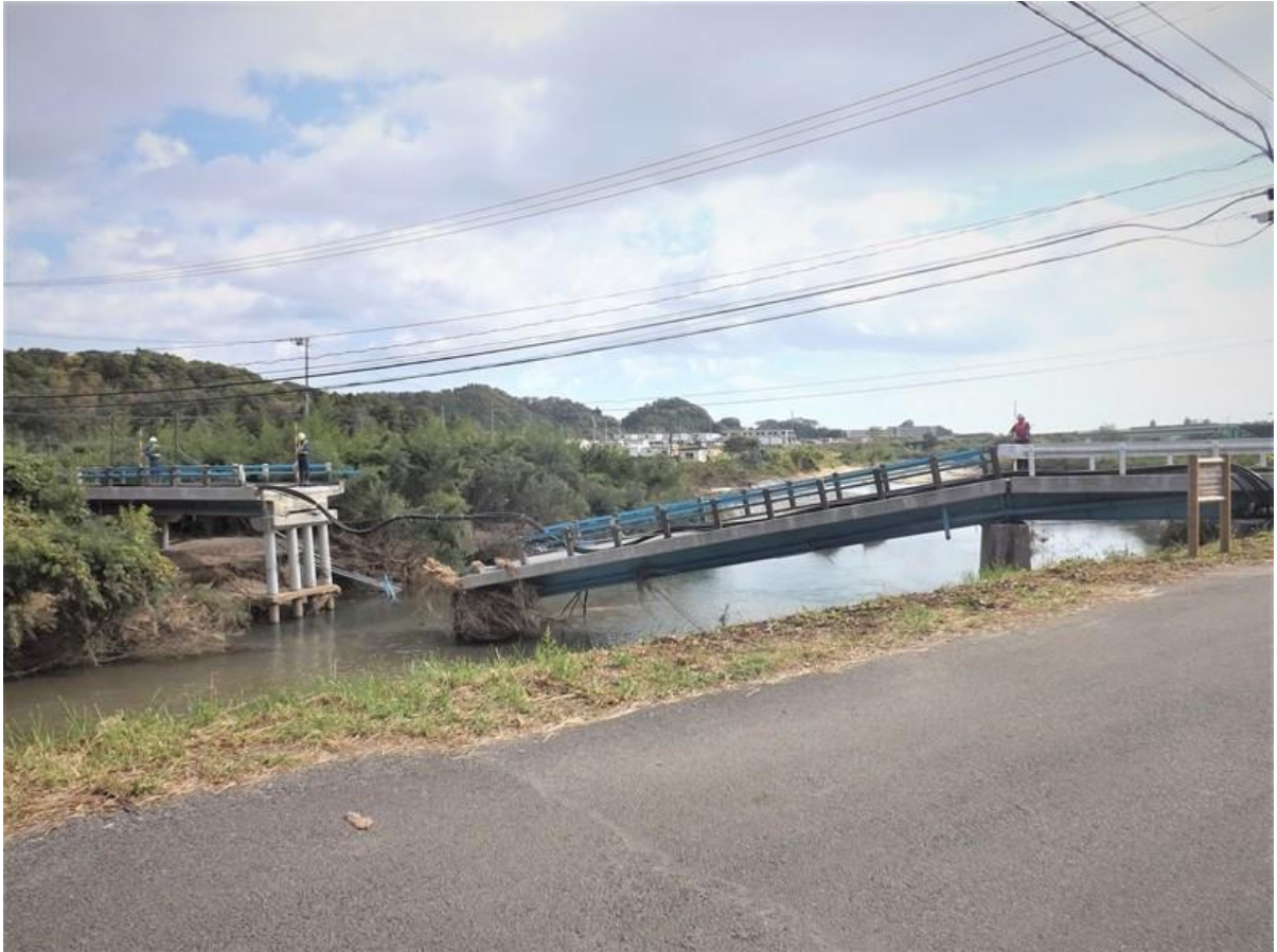
写真 3-52 落橋による添架管の破損の応急復旧 （台風第 19 号；福島県いわき市 弥宜内橋）
