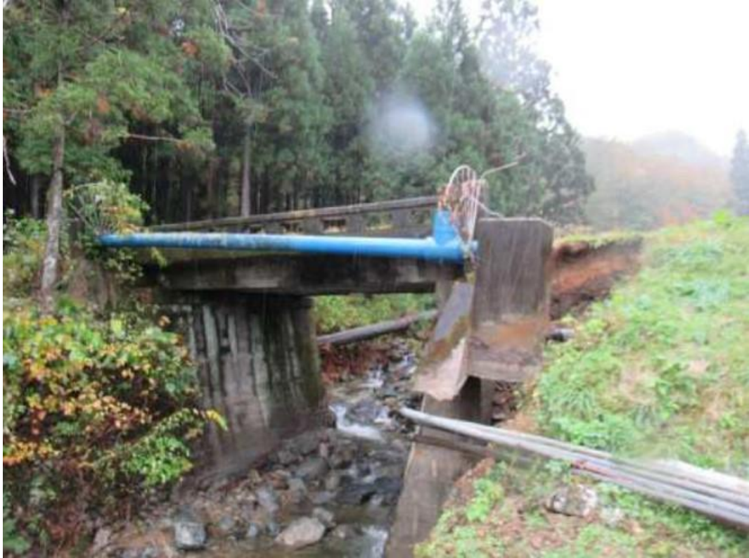
写真 3-62 水流による継手の離脱 (台風第19号；岩手県宮古市 小堀内1の橋水管橋)
