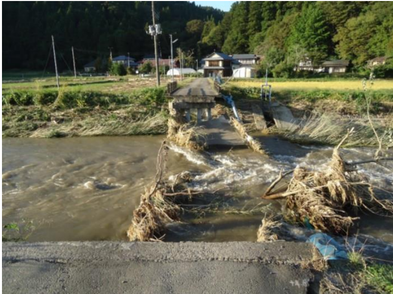
写真 3-56 落橋による添架管の破損（台風第 19 号；福島県白河市 岩崎橋）
