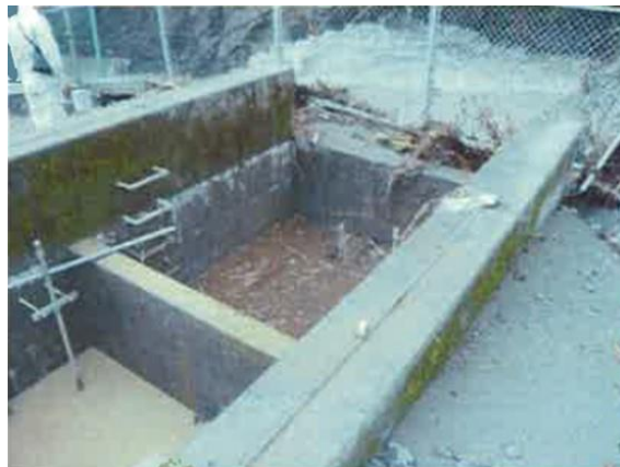
写真 3-25 取水沈殿池の土砂堆積 （台風第 19 号；埼玉県秩父広域市町村圏組合 生川浄水場）
