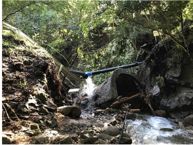
写真 3-47 地盤崩落による継手離脱（台風第 19 号；神奈川県清川村宮ヶ瀬）
