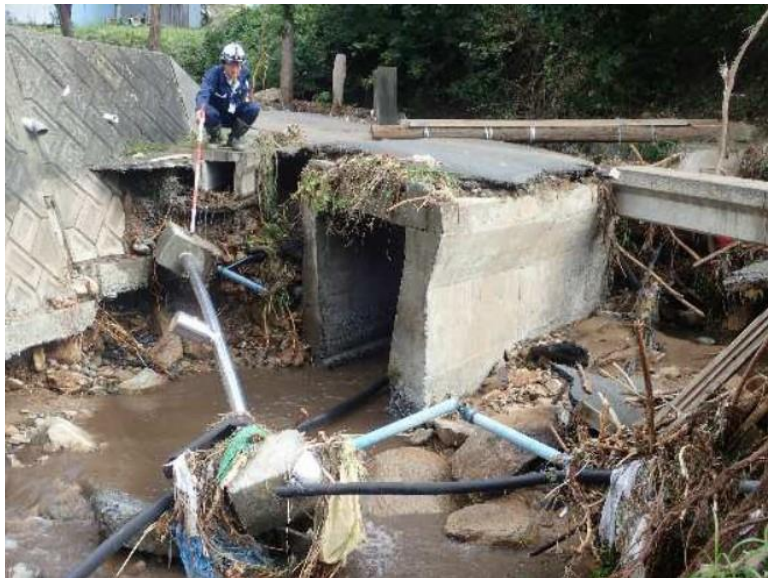
写真 3-60 河川増水による橋梁の流失（台風第 19 号；岩手県宮古市 上野一の橋添架管）
