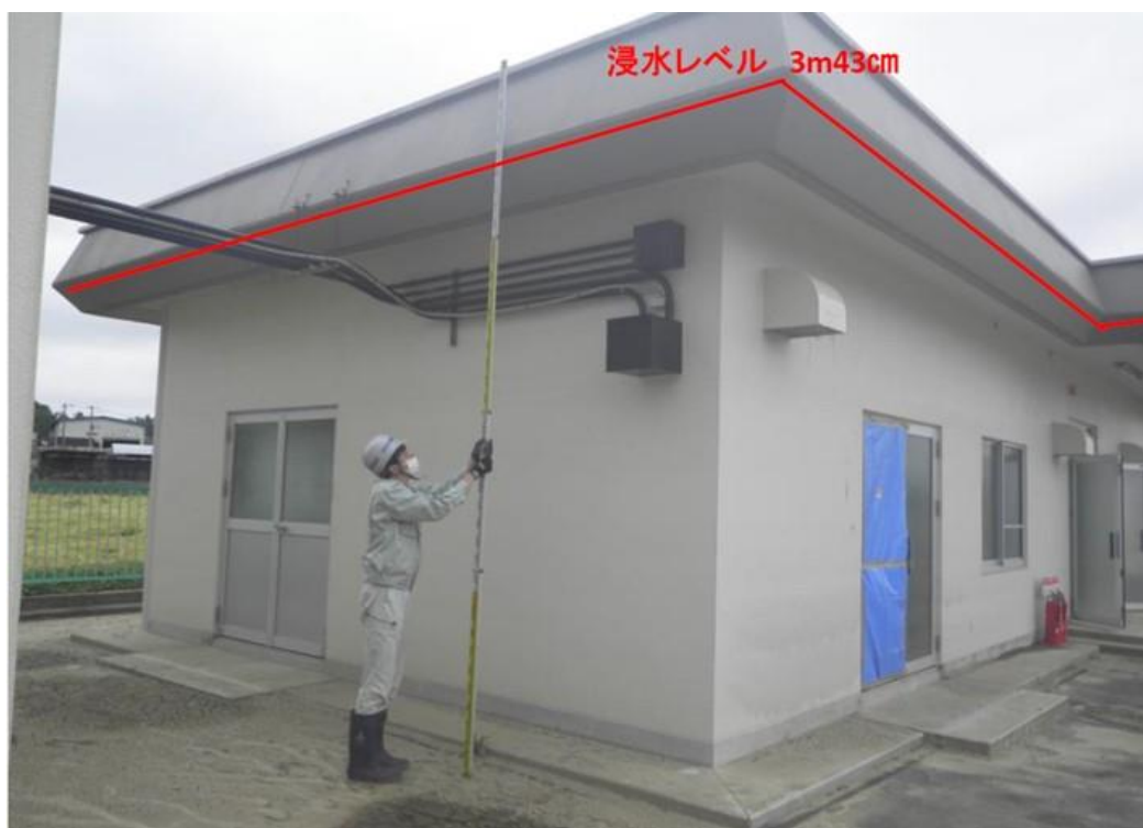
図 3-13 浸水した機械電気室（外観）（台風第 19 号；福島県鏡石町 成田浄水場）
