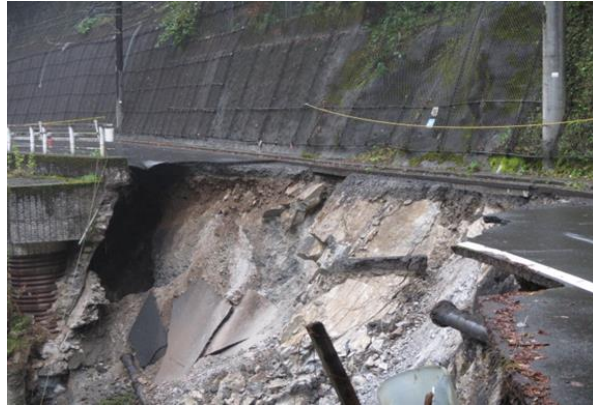
写真 3-49 道路崩落による管路の流失（台風第 19 号；東京都水道局 奥多摩町日原）
