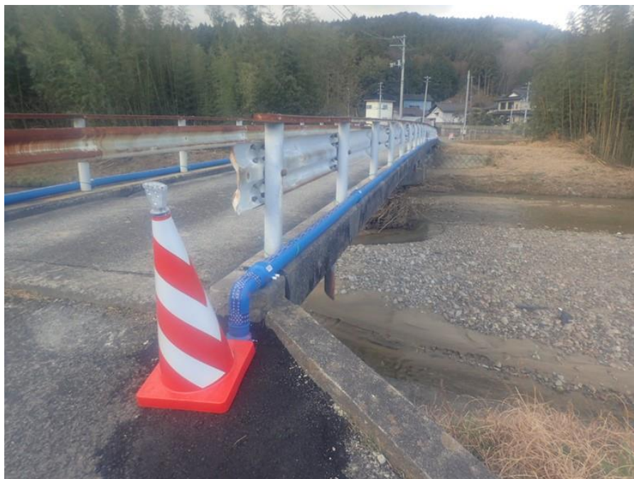
写真 3-53 落橋による添架管の破損の復旧 (台風第19号；福島県いわき市 中里橋)
