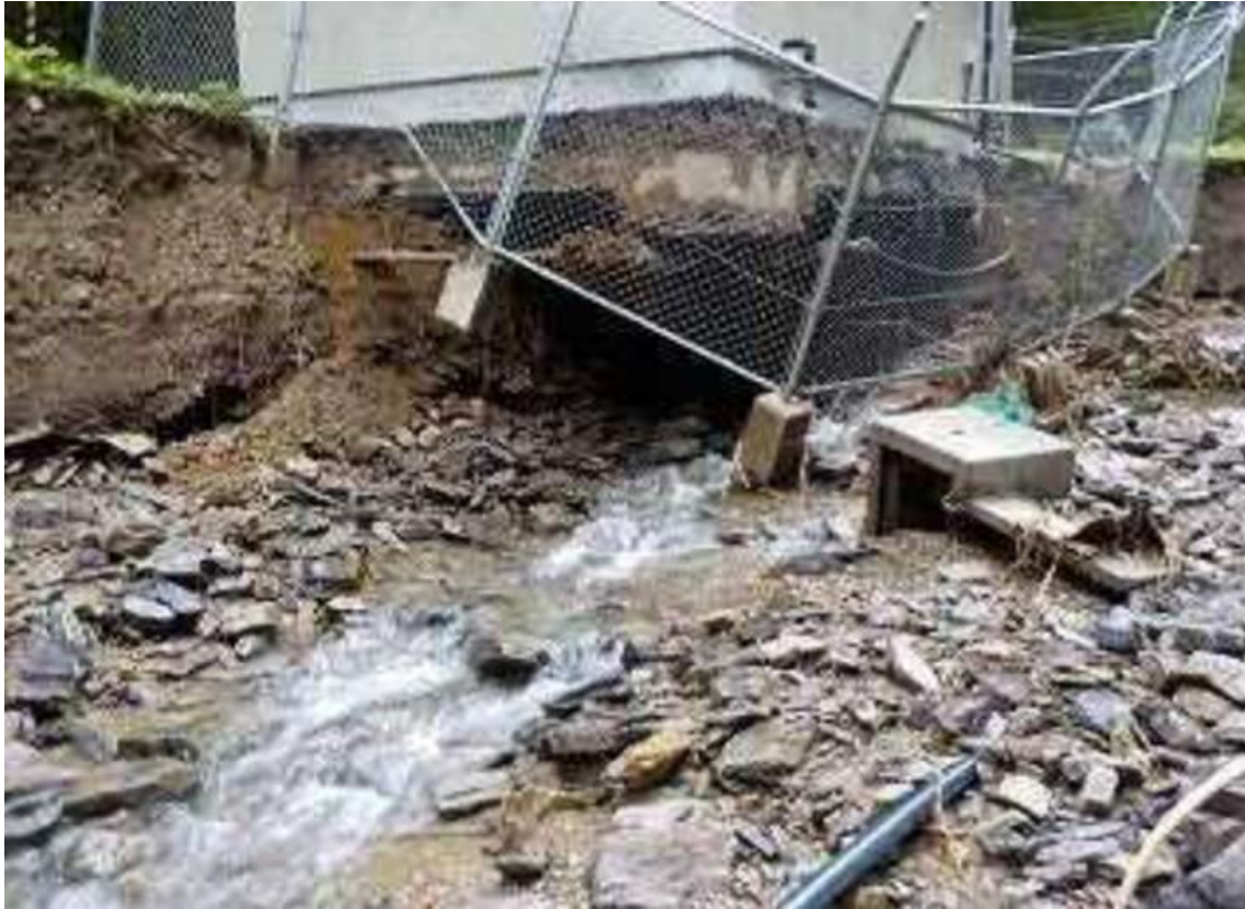
写真 3-15 建物基礎部の洗堀（台風第 19 号；宮城県登米市 大綱木浄水場）
