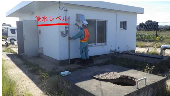
写真 3-7 ポンプ場建屋外浸水レベル（台風第19号；福島県いわき市 平窪第2ポンプ場）
