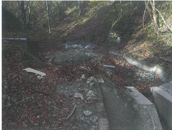
写真 3-22 取水口への土砂堆積（台風第 19 号；宮城県川崎町 青根第二浄水場）
