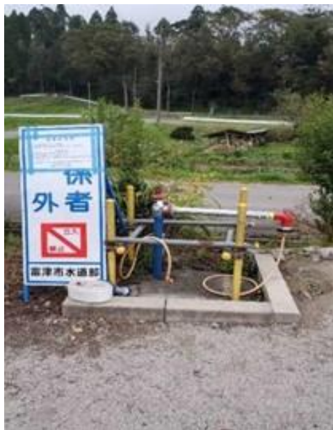
写真 5-2 仮設給水栓（台風第 15 号；千葉県かずさ水道広域連合企業団 峰上公民館）
