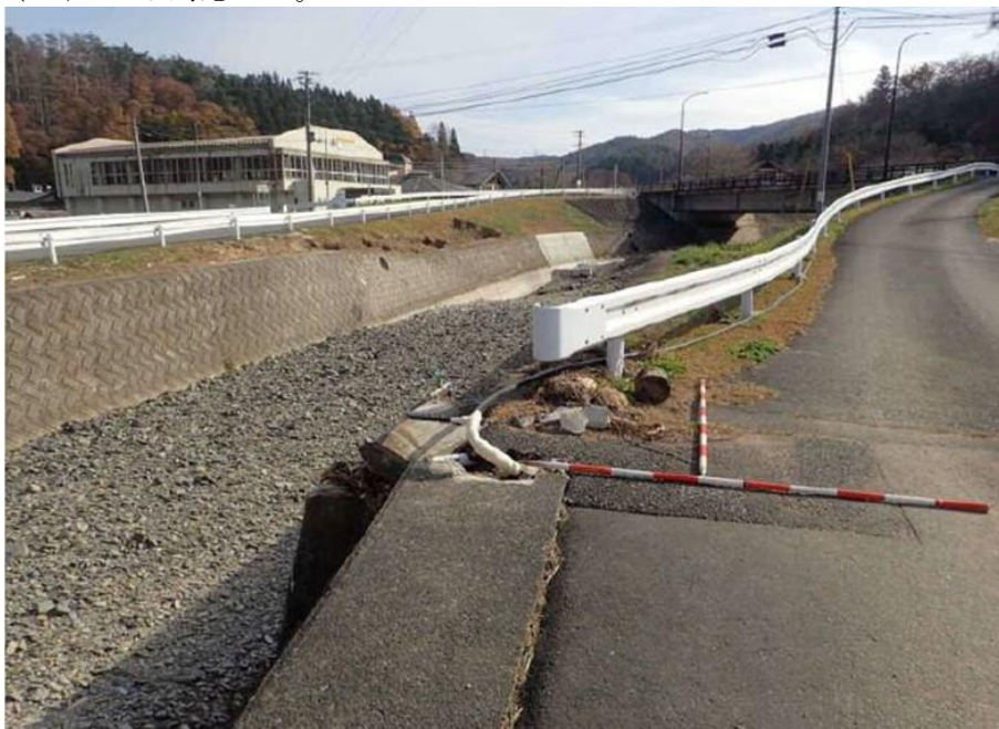
写真 3-59 仮設配管（台風第 19 号；宮城県登米市東和町 歩道橋添架管）
