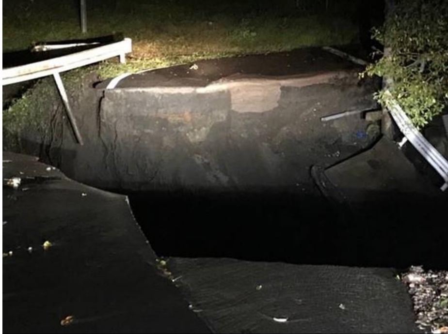
写真 3-37 水流及び土石流による道路構造物と管路の流出 (台風第 19 号；群馬県長野原町大字応桑)
