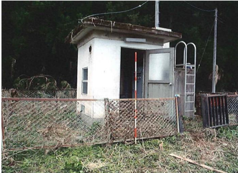
写真 3-12 取水場配電室 浸水により電気関係破損（台風第 19 号；茨城県大子町 頃藤浄水場）
