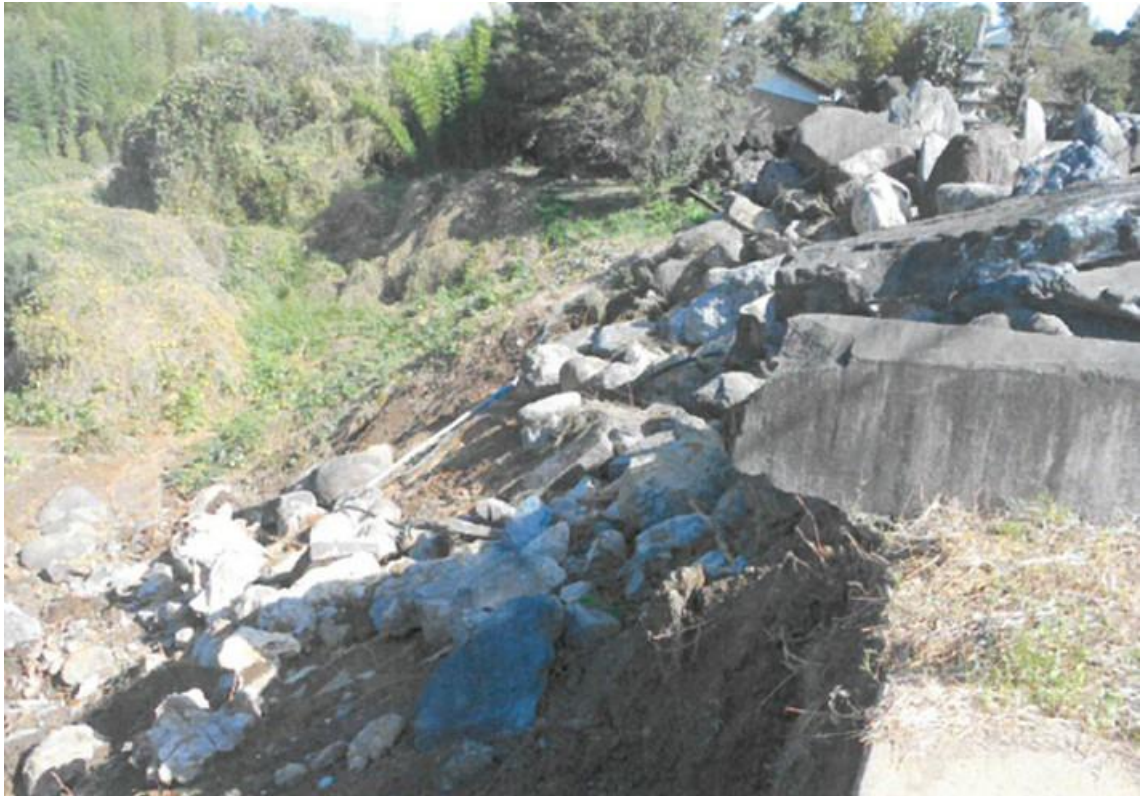
写真 3-39 埋設地の崩落による継手の離脱（台風第 19 号；埼玉県神川町大字二ノ宮）
