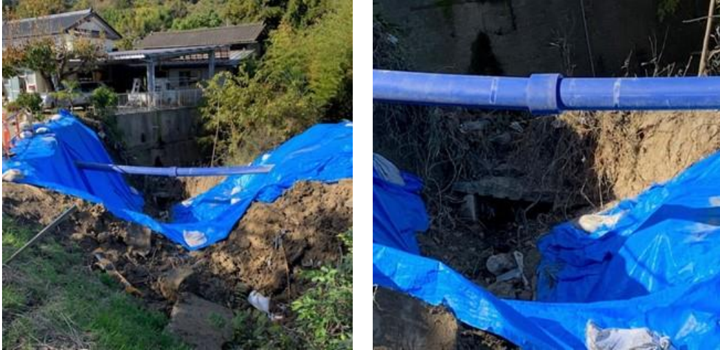
写真 3-66 道路崩落による管路の露出（台風第 19 号；福島県伊達市）
