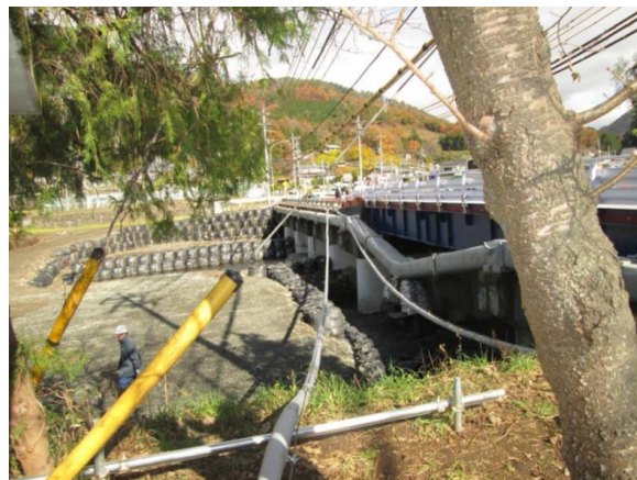
送水管（右）と配水管（左）
