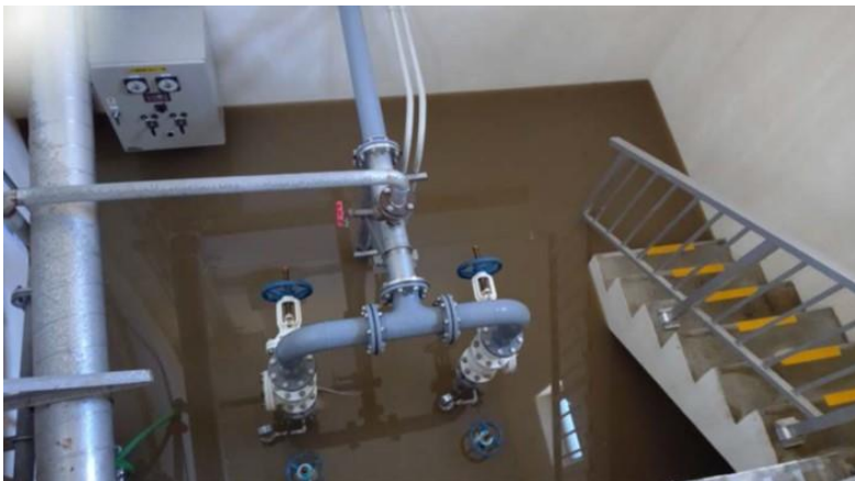
写真 3-3 2系濃縮槽地下、污泥引抜ポンプ水没（台風第 19 号；福島県いわき市 平浄水場）
