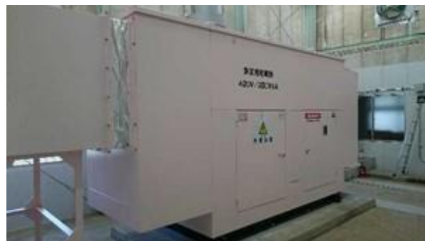
写真 5-3 ディーゼル式自家発電設備（千葉県かずさ水道広域連合企業団 上烏田浄水場）
