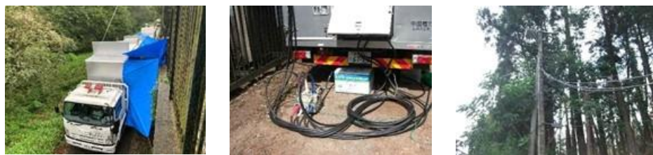
写真 5-4 電源車設置（台風第 15 号；千葉県かずさ水道広域連合企業団 第 2 中継ポンプ場）
