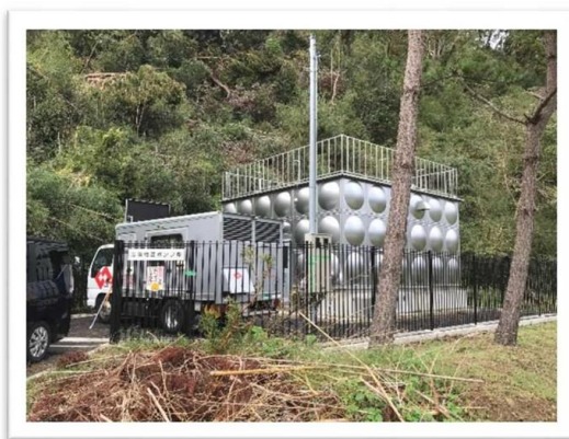
写真 5-5 電源車設置（台風第 19 号；千葉県かずさ水道広域連合企業団 志駒増圧ポンプ場）
