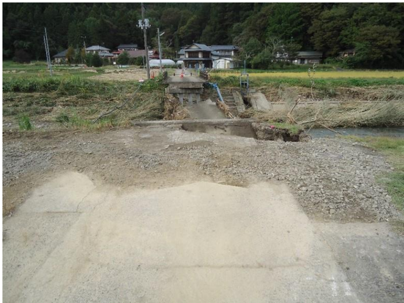
写真 3-57 落橋による添架管の破損の仮設配管による復旧 （台風第 19 号；福島県白河市 岩崎橋）
