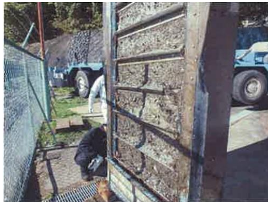
写真 3-17 過剰に土砂が流入した除塵機 (台風第 19 号；埼玉県秩父広域市町村圏組合 別所取水場)
