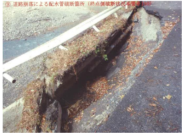
配水管破断箇所
