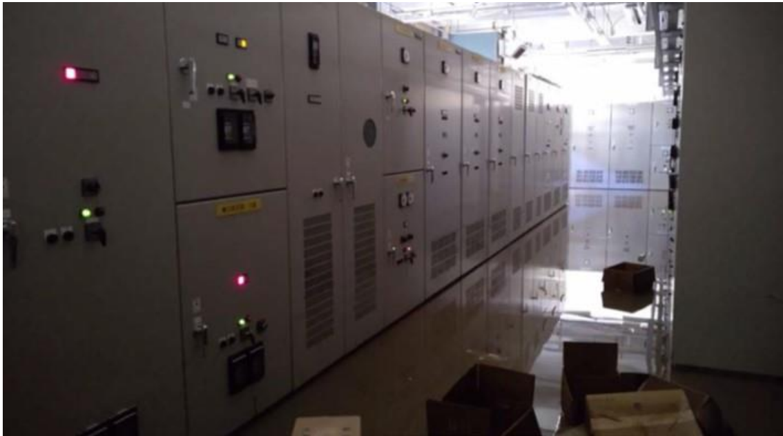
写真 3-1 電気室浸水（台風第 19 号；福島県いわき市 平浄水場）
