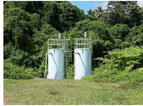
拡大写真 原地盤より低い位置に急速ろ過機がある
