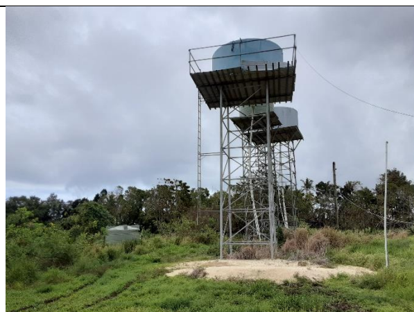
写真-36: ペア 村の村落給水施設(トンガタブ島)
