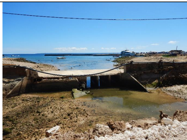
写真-9: 津波により露出した配水管(エウア島) 海底火山噴火後に発生した津波により露出した配水管。現在は復旧している。
