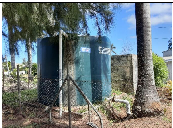
写真-8: 减压槽(エウア島) エウア島の配水エリアには約 120m の標高差があるため、2 つの减压槽が設置されている。
