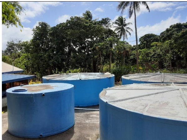
写真-17: TWB ハアパイ支所内の配水池 (リフカ島)
