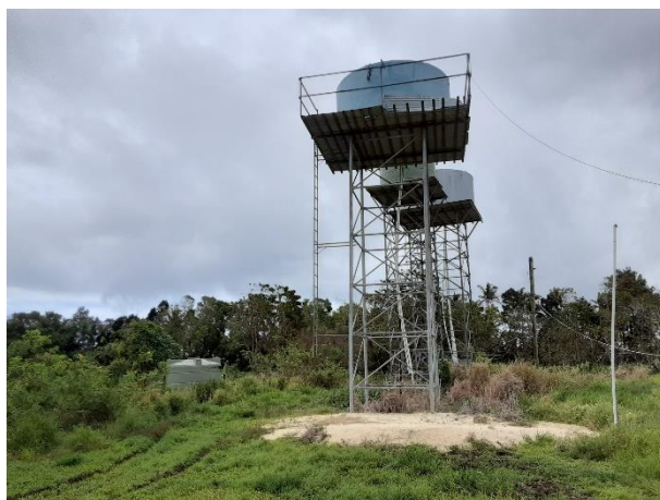
写真 2.10 既存給水エリア近隣に位置する ペア村の給水施設
