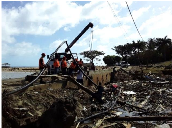
津波による配水管の被害状況(エウア島)
