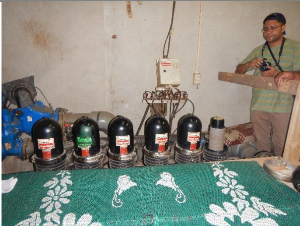
写真-3: マタヴァイ浄水場の故障した膜ろ過装置 (エウア島)
