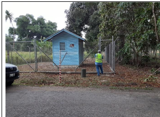
写真-31: 既存の取水井戸群(トンガタブ島)
