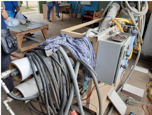
写真 2.6 故障した海水淡水化装置
