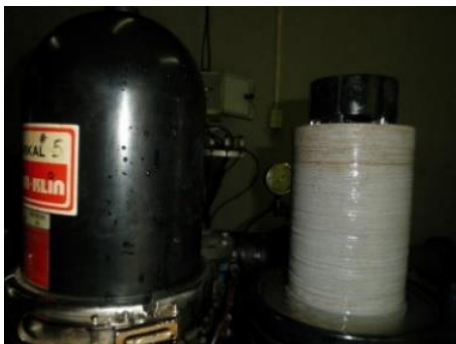
使用されている膜ユニット
