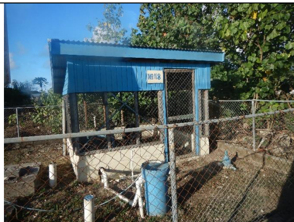
写真-14: 取水井戸 (リフカ島)
