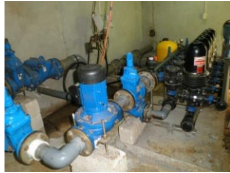
導入された膜ろ過装置
