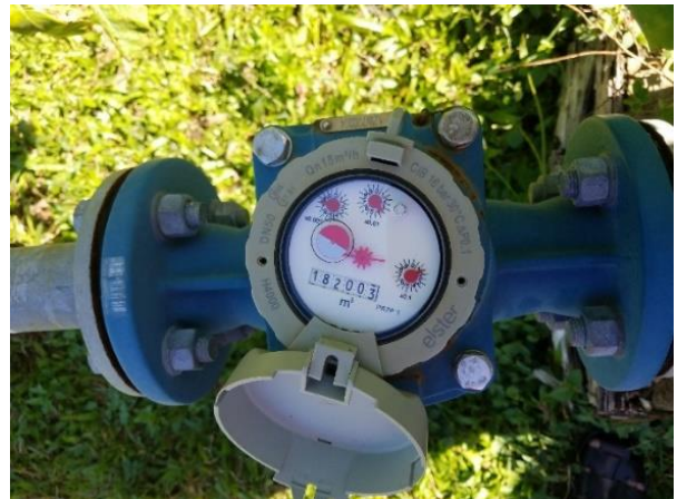
写真 2.5 故障したままの流量計
