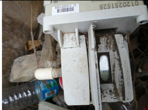
写真-37: TWB 本部近くのスマートメーター(トンガタブ島) トンガタブ島では 2019 年 10 月～2020 年 3 月にかけて、全面的に機械式の水道メーターから、スマートメーターへの更新を行っている。その結果、有収水量が大幅に増加したとして、TWB 内での評価は高い。
