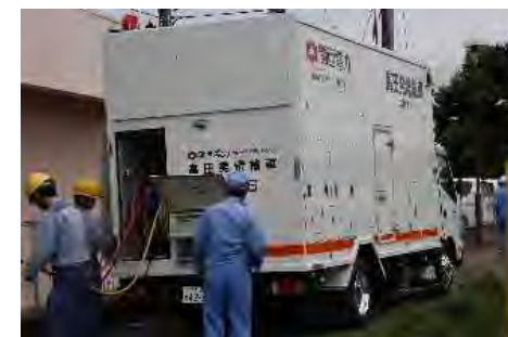
電源車の配備
