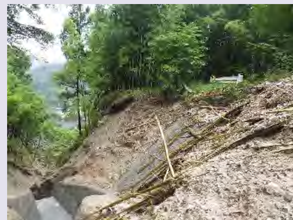
配水管を添架していた道路橋の流出 (長野県上松町)
