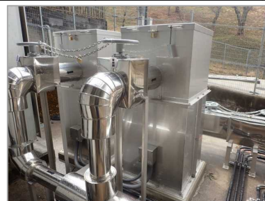
加圧ポンプ 1号(5.5kW)、2号(5.5kW)
