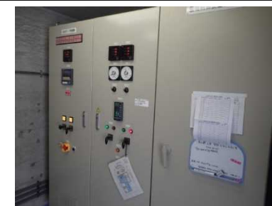
ポンプ制御盤 インバータ機器(5.5kW)
