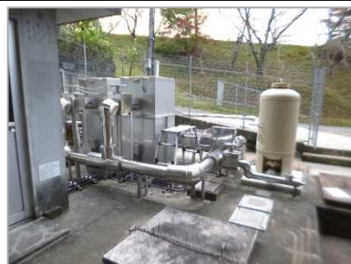
概観 左：加圧ポンプ2基 右：圧力タンク
