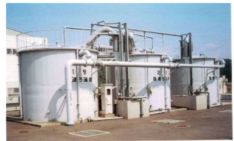
浄水量：5,280m 3 /日
