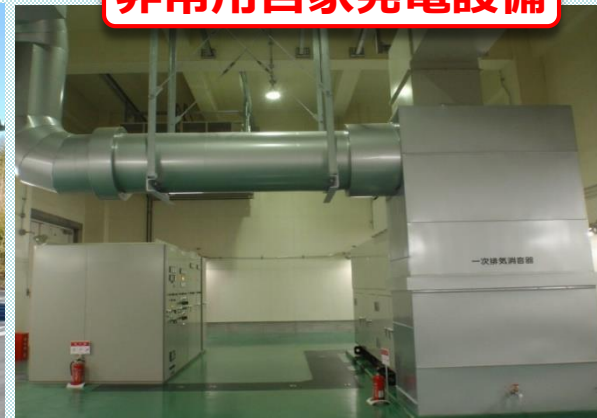
非常用自家発電設備
