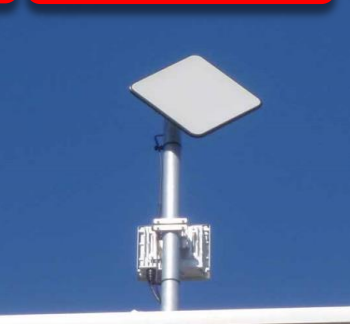
無線LAN設備
