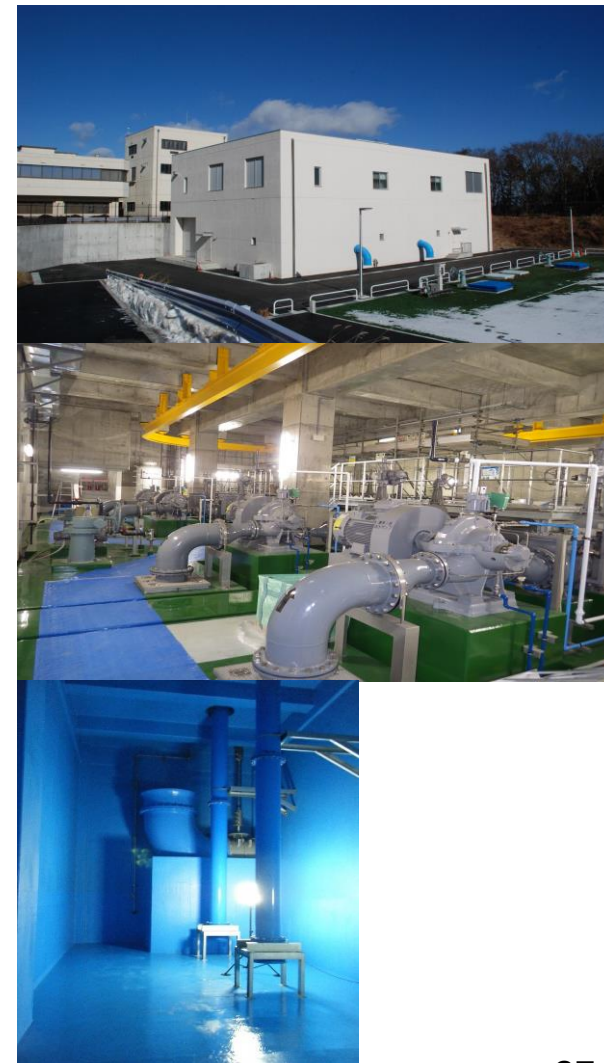
送水ポンプ棟
