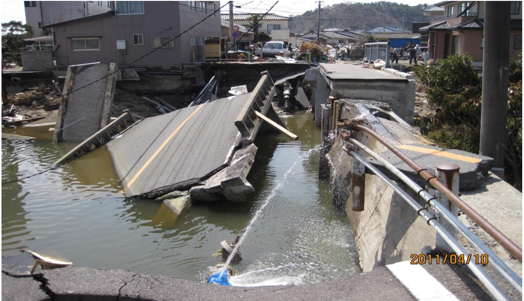
写真 津波により橋梁ごと流出したφ150mm配水管(永崎:大平橋)
